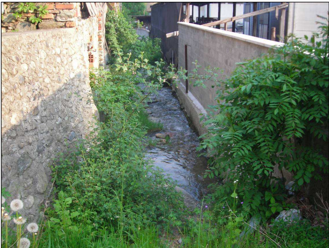
Vista 6 – Tratto tra capannoni, con sponde cementate ed in parte erose
